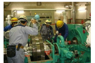
タービン-発電機間 芯出調整
